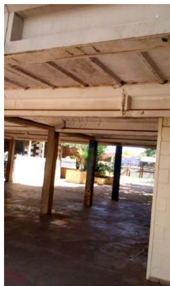
teto com pintura descascada e sinais de umidade
