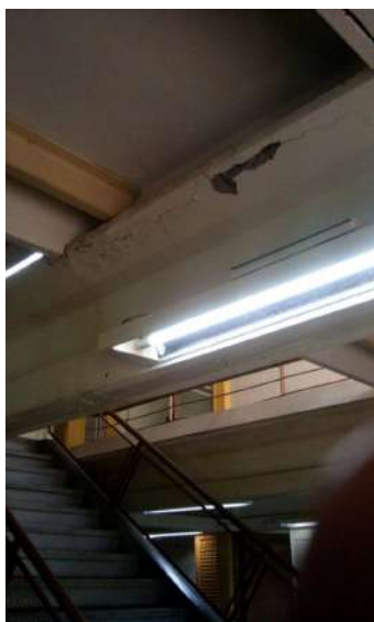
rachadura na viga
