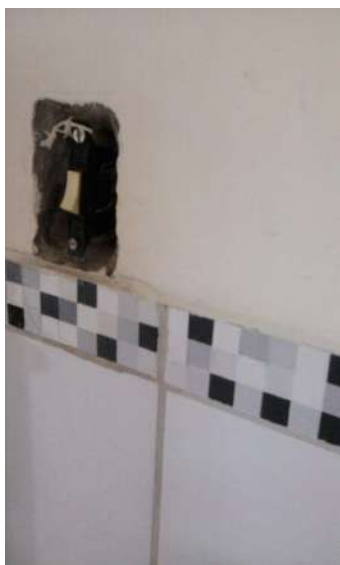
interruptor Aberto banheiro masc 1 piso
