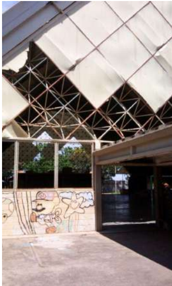
laterais da cobertura da quadra danificada
