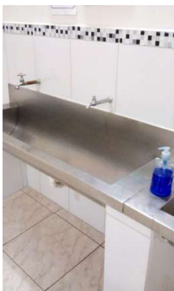
torneira quebrada banheiro feminino 1 andar
