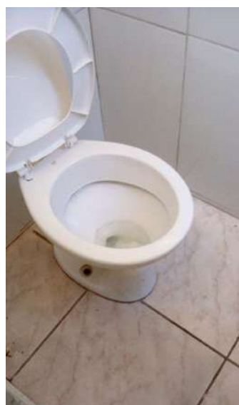
vazamento banheiro masculino 2 andar
