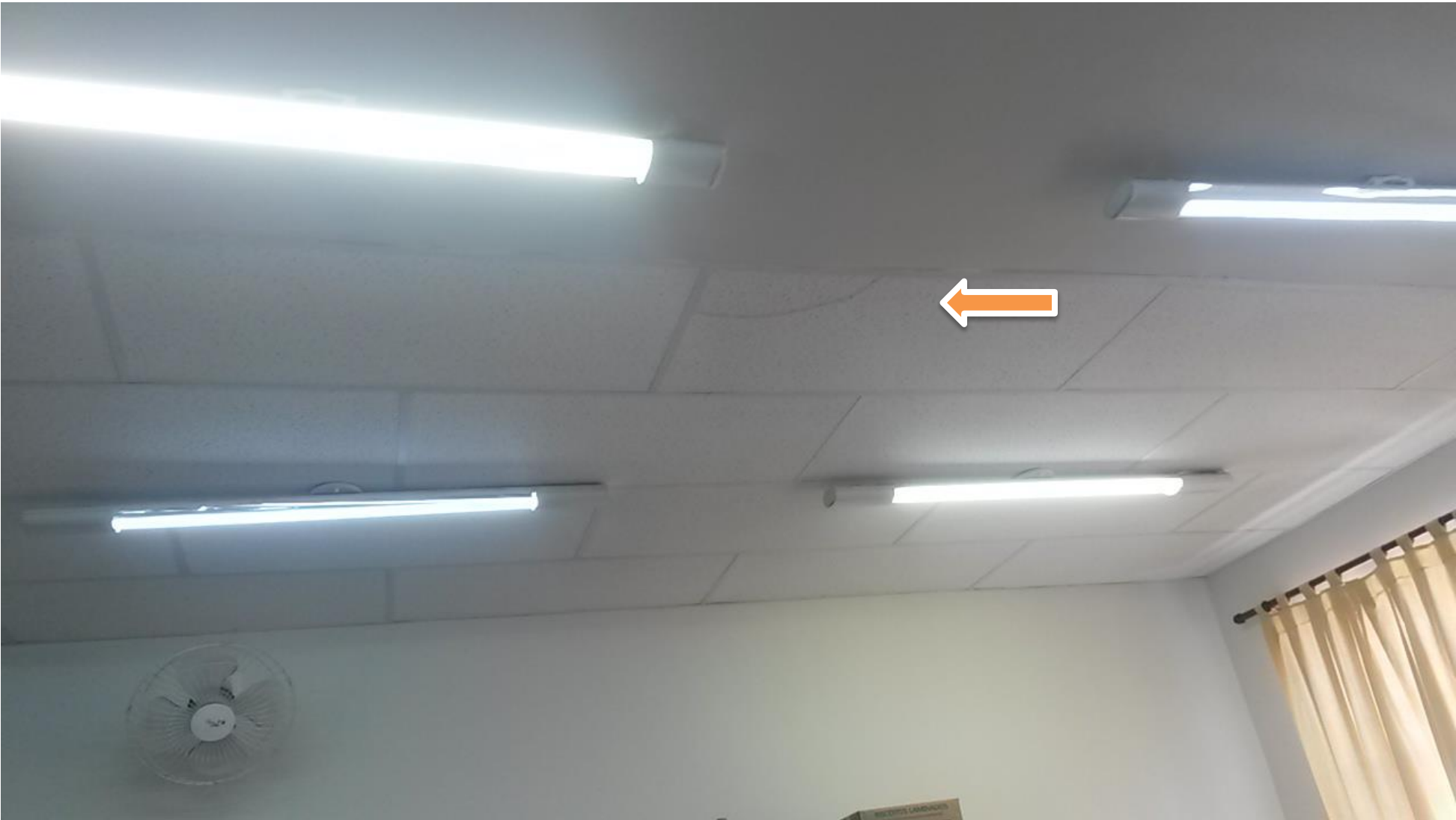
Foto 5 – Infiltração na sala de aula
