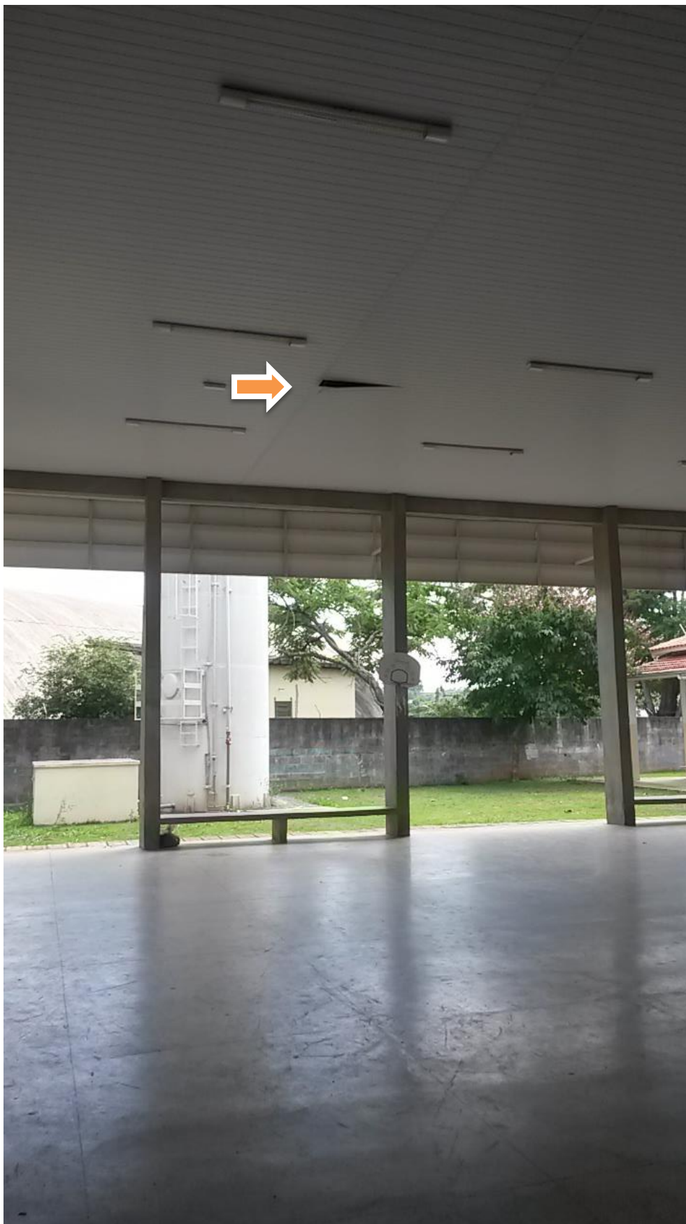
Foto 8 – Forro do pátio da escola avariado
