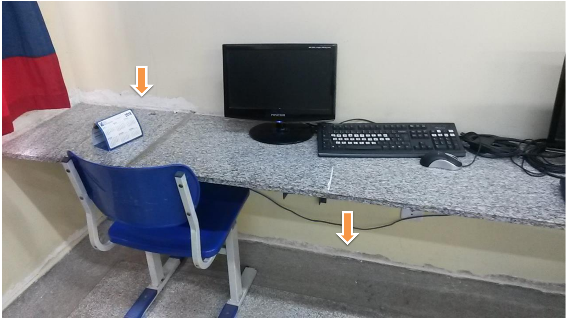
Foto 6 – Falta de Acabamento na sala de informática
