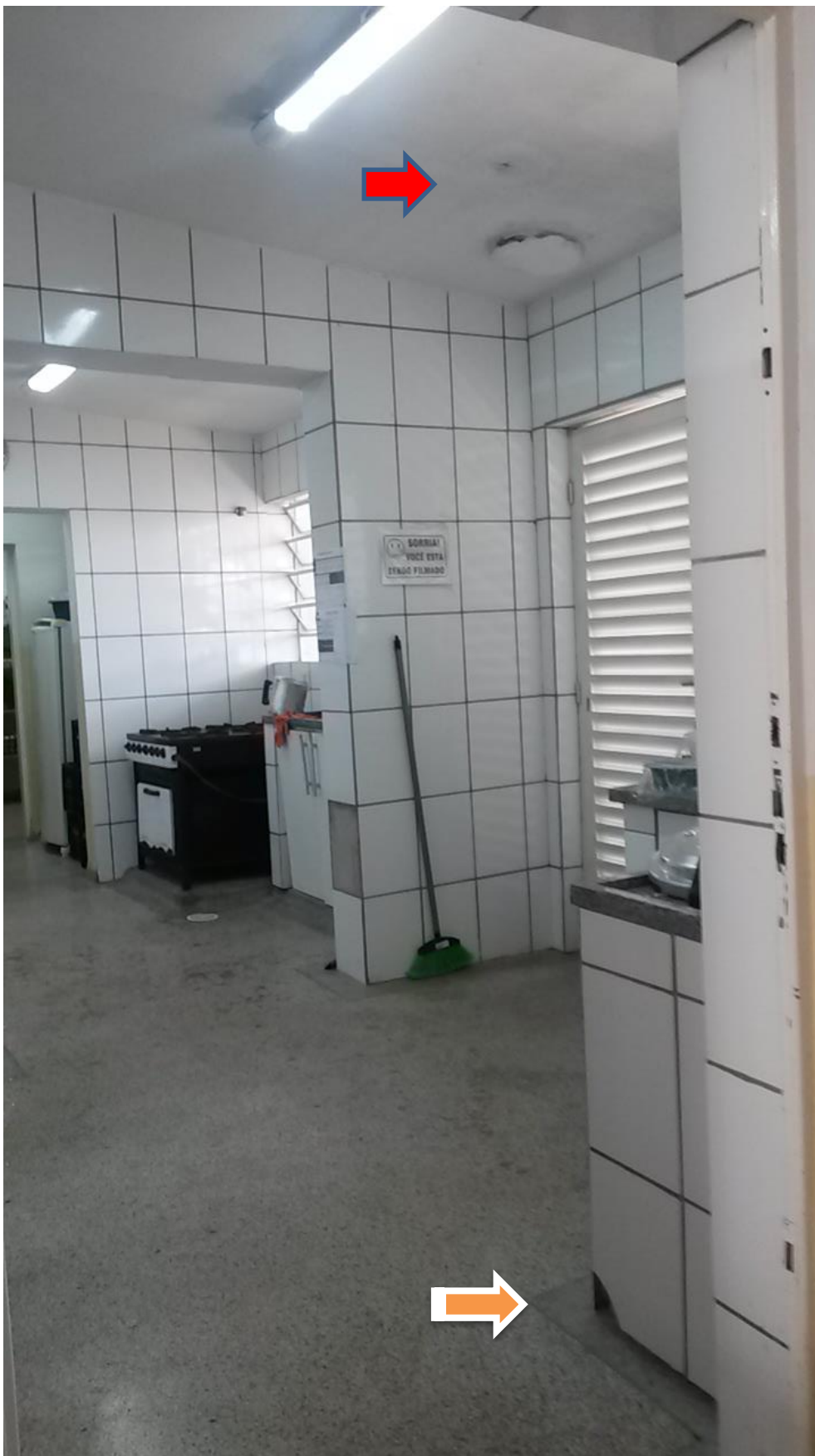
Foto 7 – Cerâmica Quebrada e infiltração
