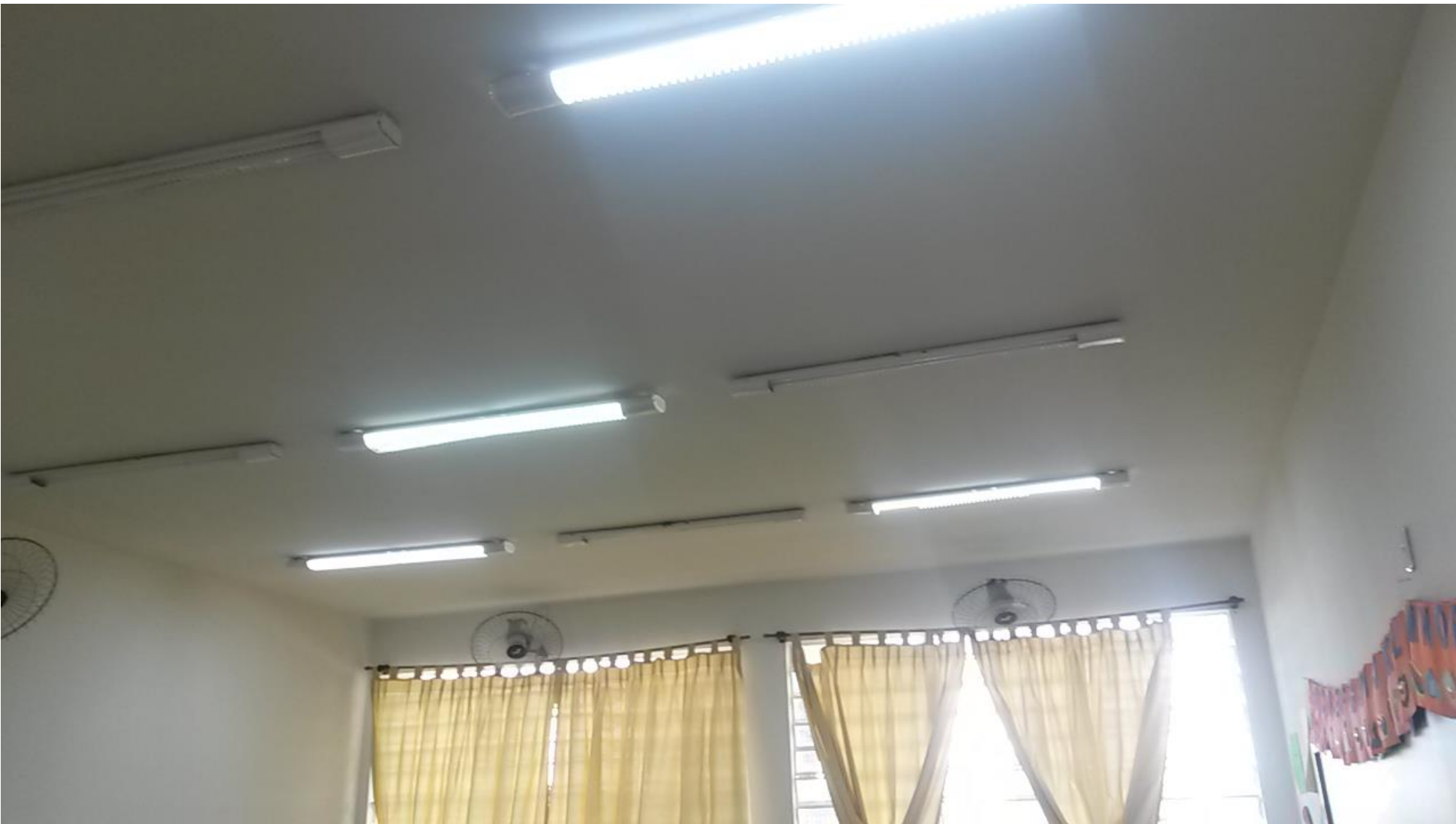
Foto 2 – metade das lâmpadas de uma das salas de aula não acende
