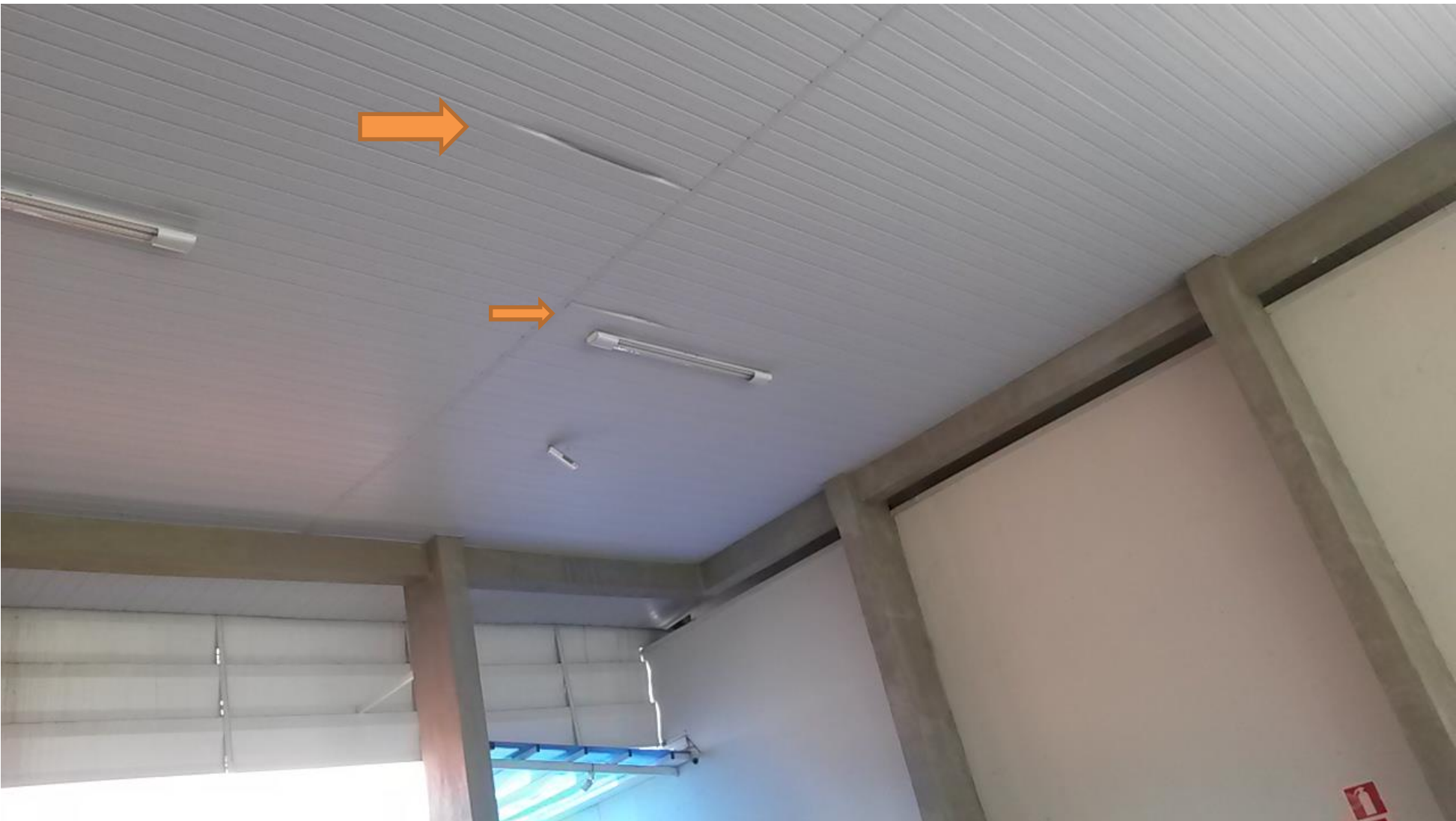
Foto 9 – Forro do pátio da escola avariado
