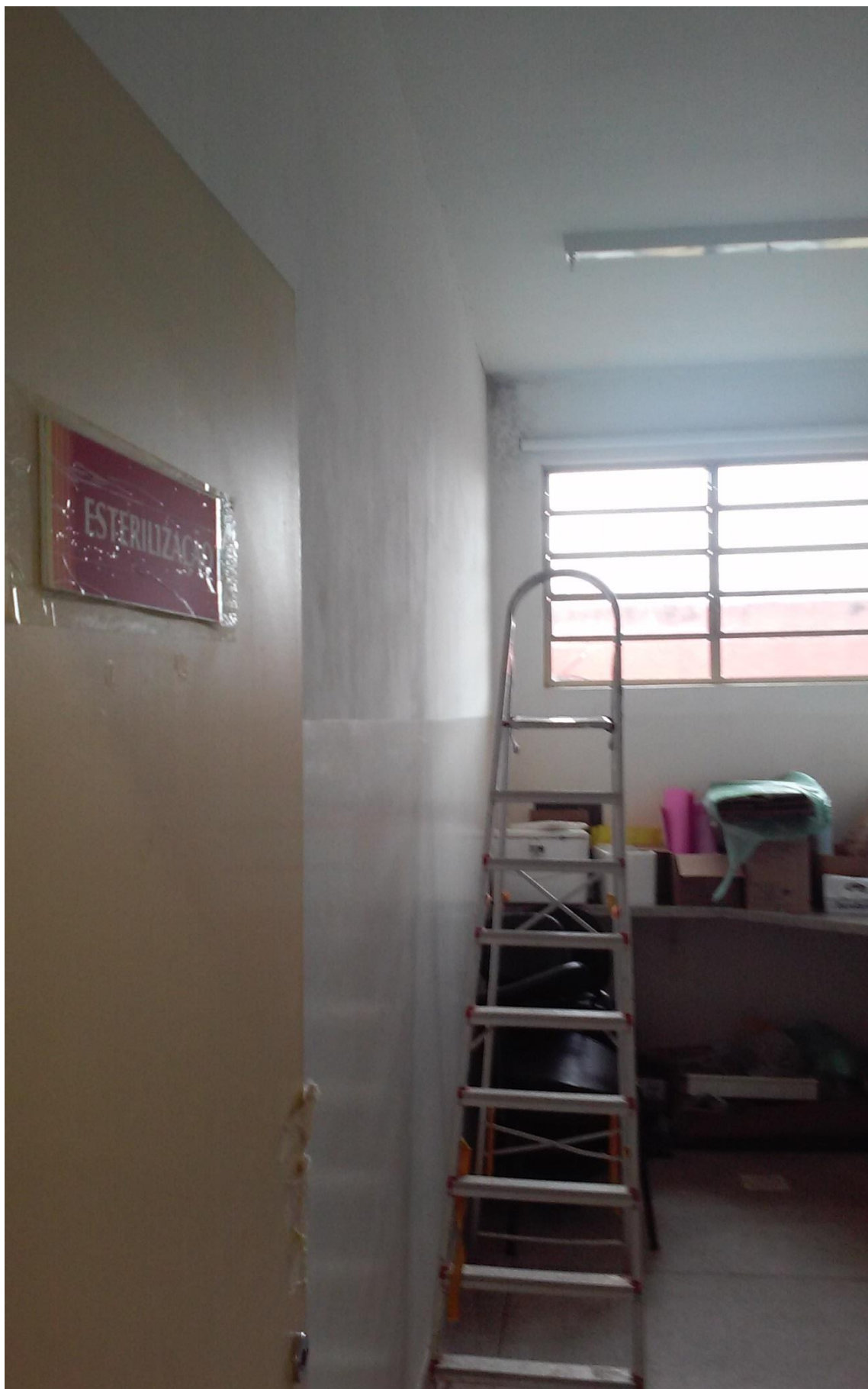
Foto 4 – Sala de esterilização com infiltração
