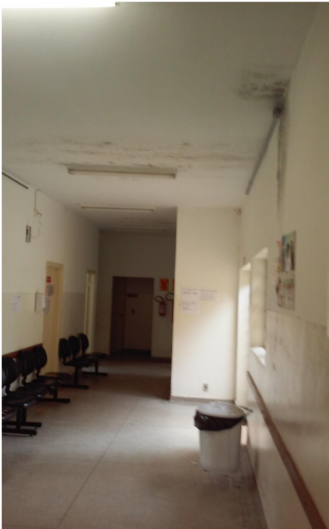
Foto 2 – Corredor com infiltrações
