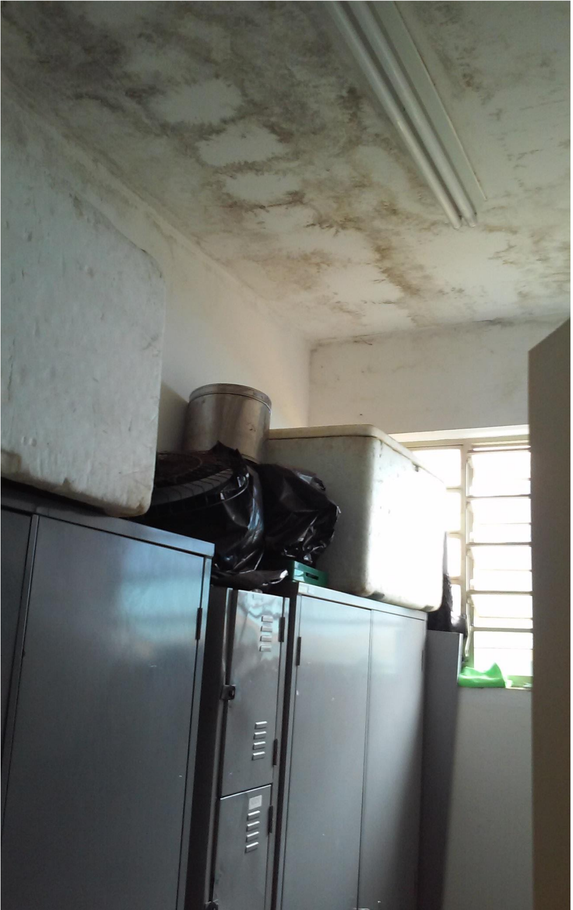
Foto 5 – Vestiário com infiltração
