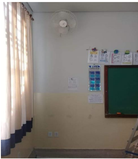
Antes: sem instalação elétrica
