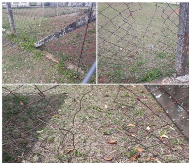
Buracos no alambrado. Orçamento para a realização do serviço de conserto está sendo feito.
